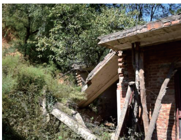
图6 小横岭村崩塌毁坏房屋
